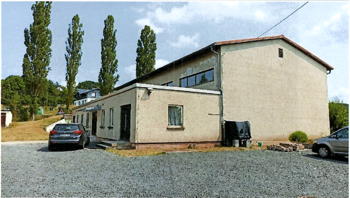
Abbildung 34 Turnhalle mit hohem Sanierungsbedarf
