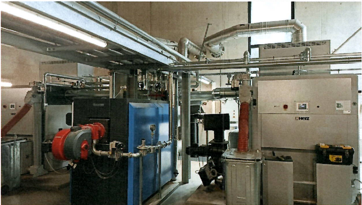
Abbildung 55 Hackschnitzelheizung mit Gasbrenner (2023)
