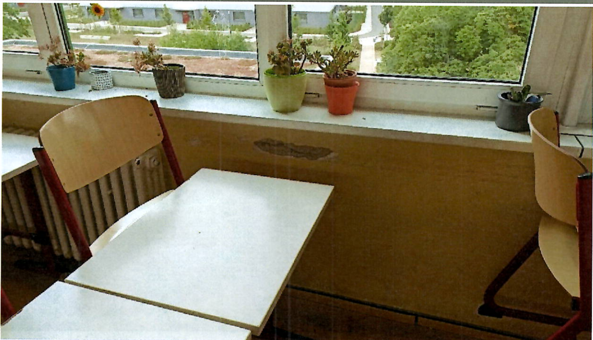
Abbildung 19 Putzabplatzungen im Klassenzimmer
