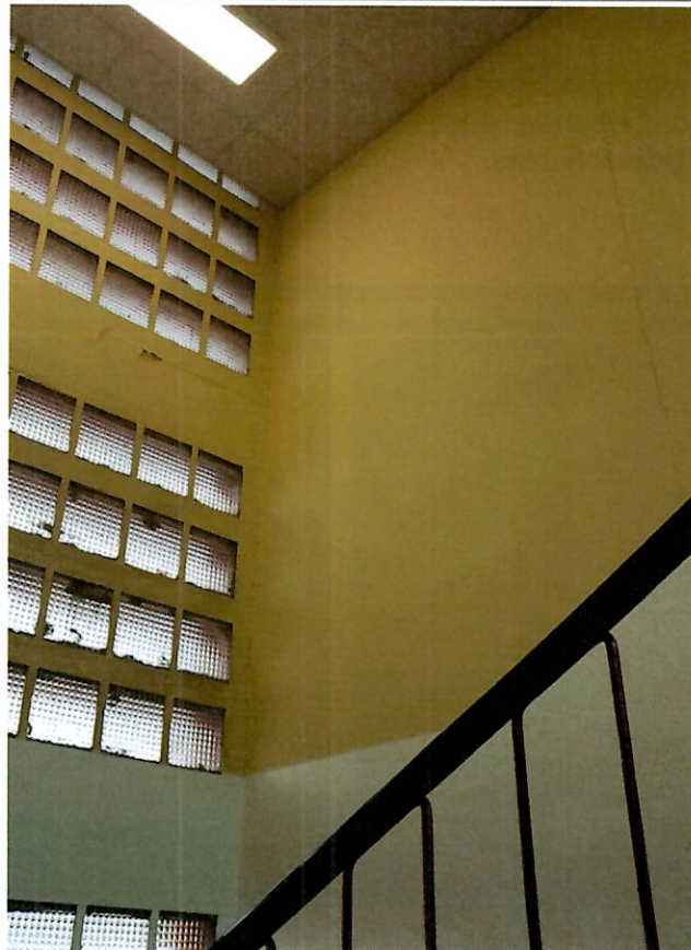
Abbildung 4 Brandschutzmängel im Rettungsweg
