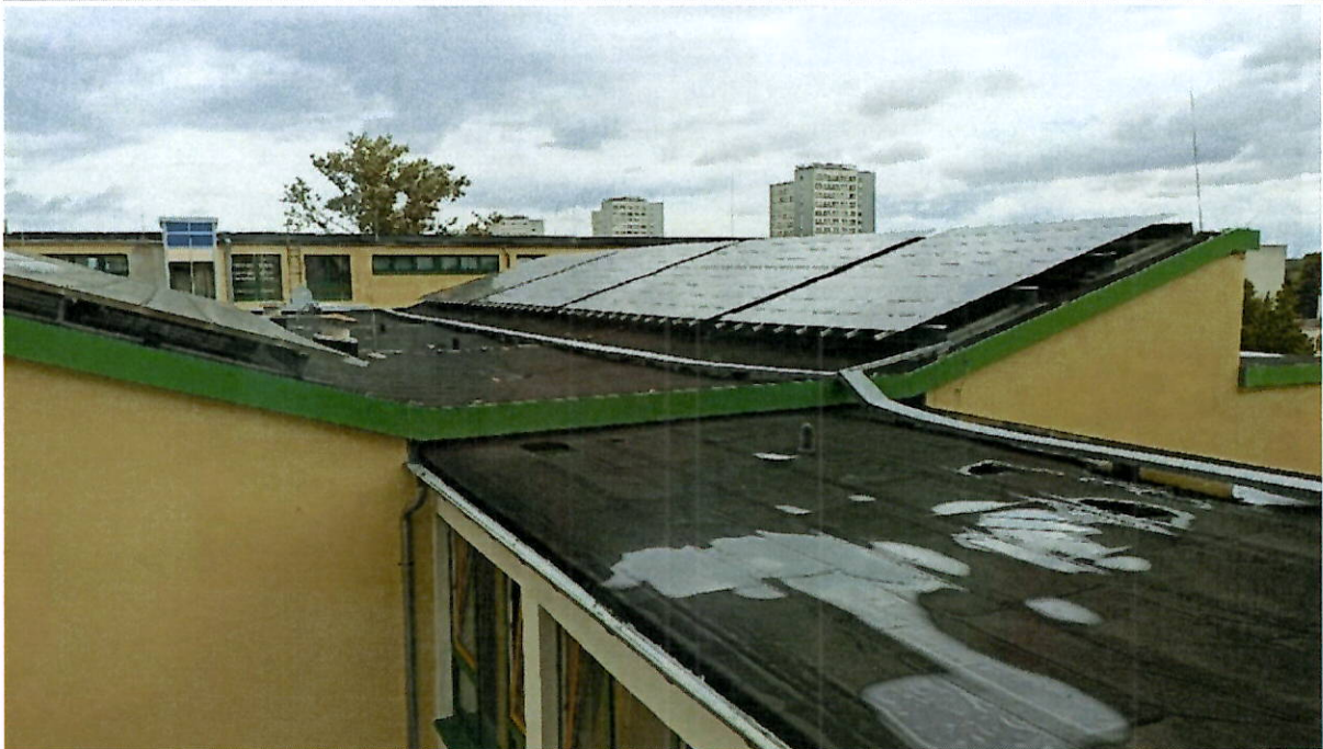
Abbildung 16 Sanierungsbefürftiges Flachdach Typenbau
