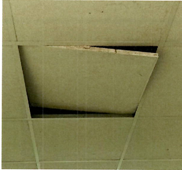
Abbildung 3 Lose Elemente in der Abhangdecke
