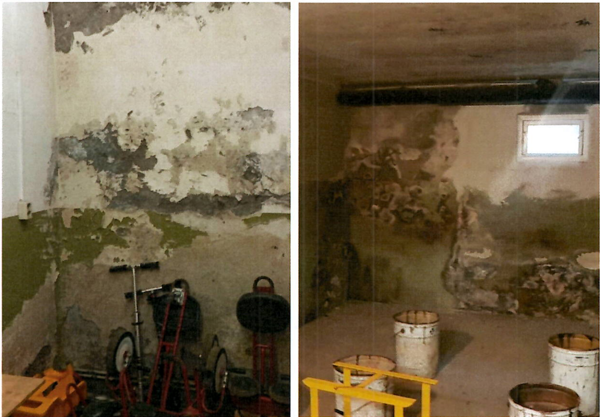
Abbildung 20 Durchfeuchtete Wände im Bestandskeller
